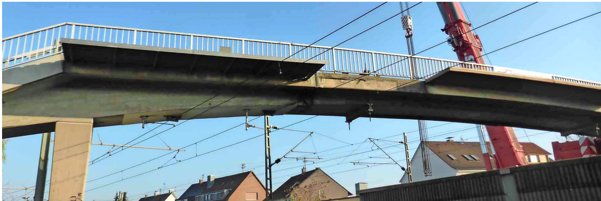
Viele Bauwerke erreichen nicht ihre ursprünglich vorgesehene Nutzungsdauer und müssen vorher aufwändig saniert werden. FOTO: KIT
